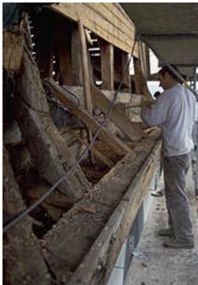
Schlechter Holzzustand in Kehlen und Gräten
