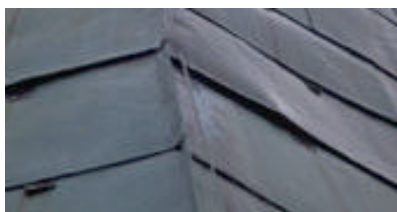
Das Dach von 1909 mit Windrissen und Blechaurissen wegen ungenügender Überfällung
