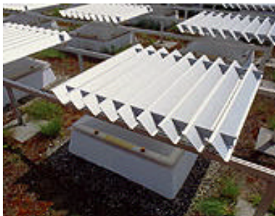
Sonnenschutzlamellen in Reihen für insgesamt 36 Lichtkuppeln (Migros Markt, Meilen)
